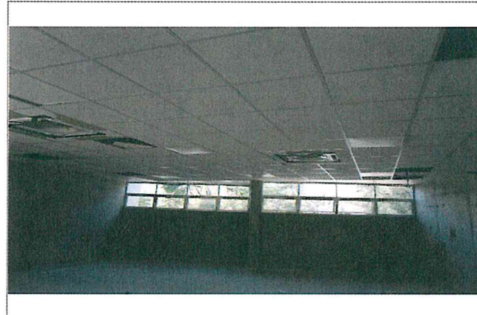
F2: Equipos de A/A cassette
