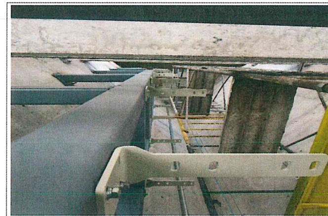
F5: Rieles y accesorios fijación cabina elevador
